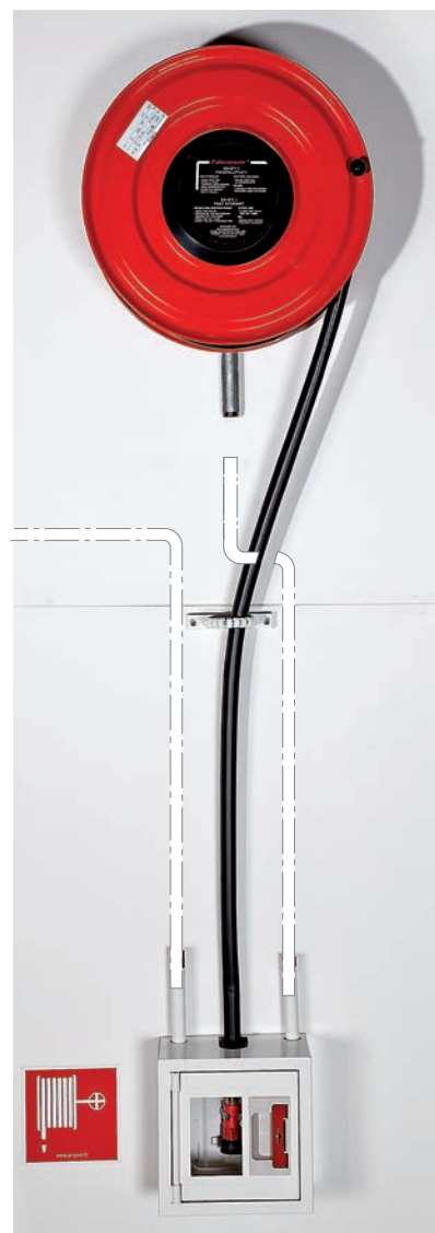
PV-23 slangrulle och PV-7 SV pelarpost
