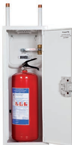
PV-57 SV och brandsläckare Brandsläckare på sidan 22.
